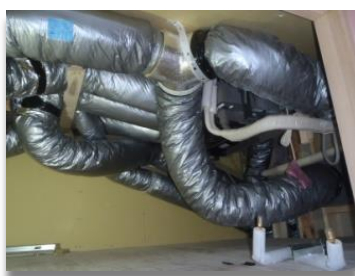
天井裏ダクト
